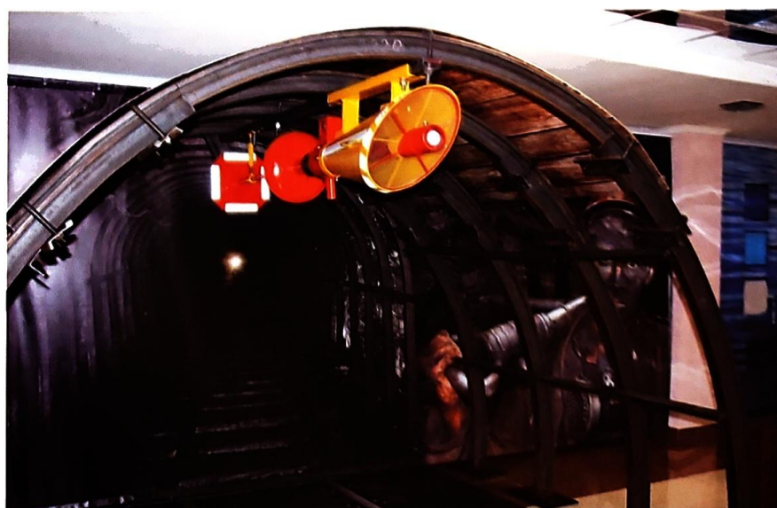
Так устанавливается в горной выработке автоматическая система АСВП-ЛВ.МФУ, обеспечивающая безопасность на новом уровне
