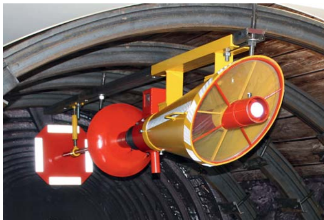
Автоматическая система взрывоподавления-локализации взрывов (АСВП-ЛВ.1М), установленная в шахте
